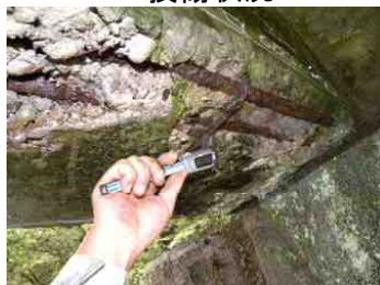
主桁の鉄筋露出
