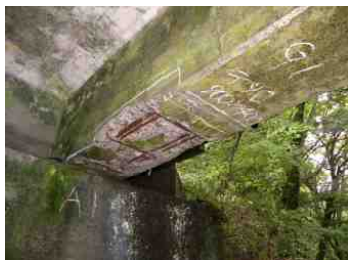
主桁の鉄筋露出
