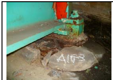
【損傷写真(支承部)】
